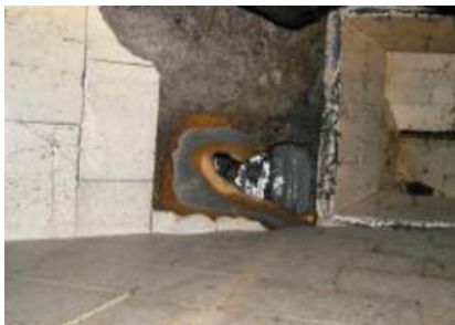
Versagen einer mit Fliesen ausgekleideten Rutsche nach vier Monaten vor der Reparatur durch Auftragschweißung.
