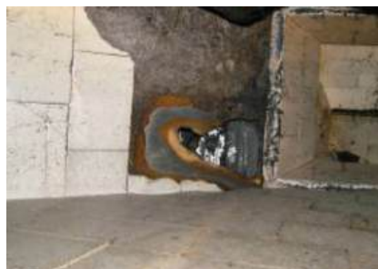
Rupture de la goulotte revêtue de carreaux après quatre mois, avant le rebouchage.
